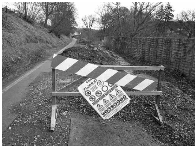
Silnice do Velkých Přílep je stále neprůjezdná
